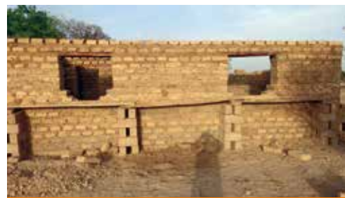
建設中のブラジェ村産院(5月時点)。この後更に建設が進みましたが、6月中旬にイスラム過激派によって破壊されました。
